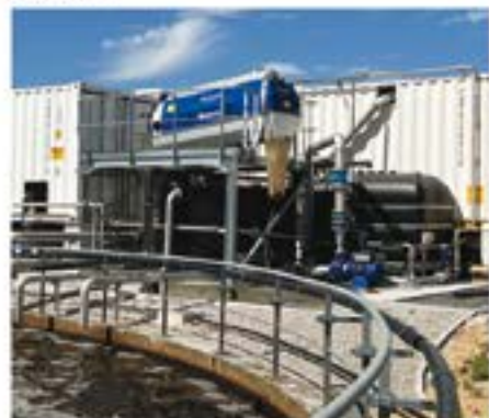
Re-Use d'eau de station d'épuration en appoint des TAR
